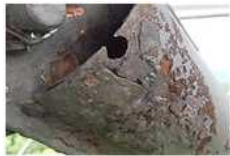
鉄塔 (部材発錆)
