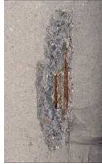
電柱 (コンクリート剥離)
