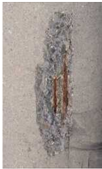
電柱 (コンクリート剥離)
