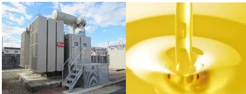
▲ 植物油系絶縁油を用いた変圧器の導入促進
