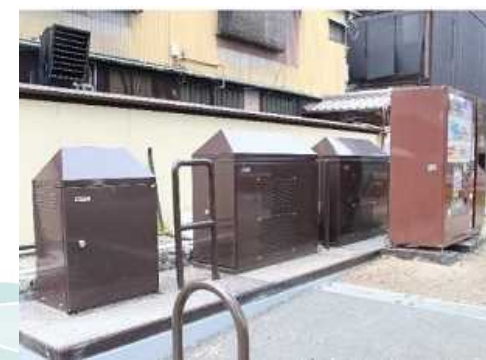
▲景観に配慮して設置された変圧器
