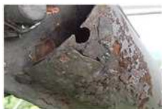
鉄塔 (部材発錆)
