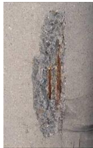
電柱 (コンクリート剥離)
