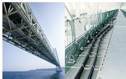
再エネ電源導入拡大のため増強予定のケーブル(明石海峡大橋)
