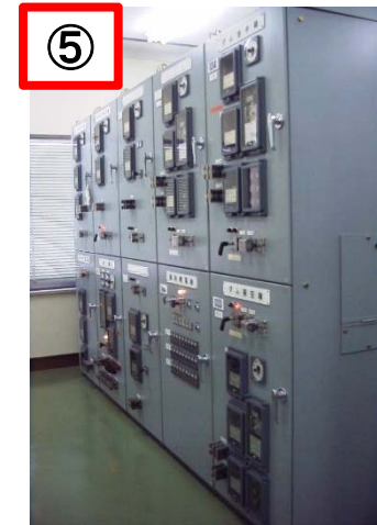
<供給用キュービクル>
