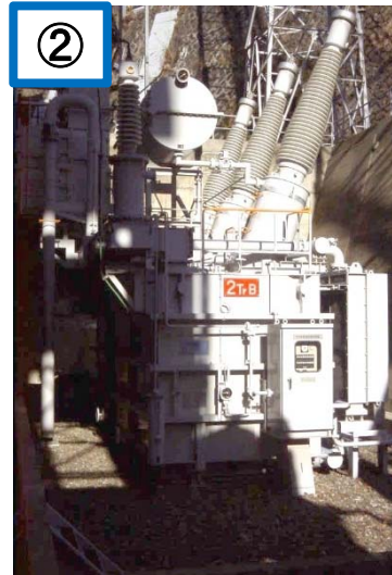
<発電用変圧器>
