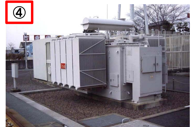
<供給用変圧器>
